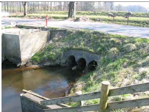
Udløb fra underføring
